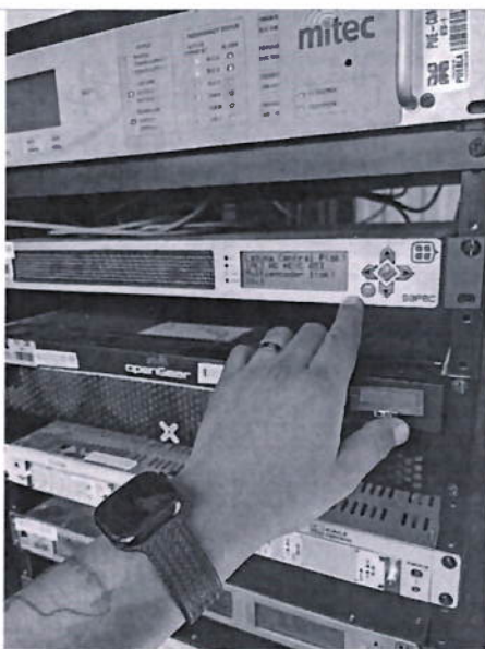
Revisión de los parámetros del encoder unae las etapas de transmisión)
