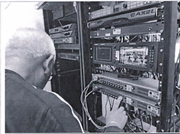
Mantenimiento preventivo de sistema de comunicación
